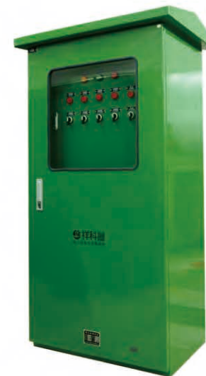
户外照明控制柜
